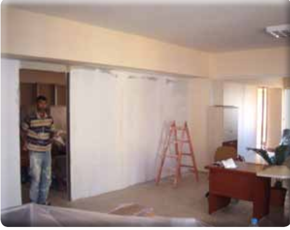
Sevgi Mah. Atatürk Kültür Merkezinde bulunan müdürlüklerimizin kullanımı amaçlı, alçıpan duvar bölme işlemi gerçekleştirilip, boya işleri tamamlanmıştır.
