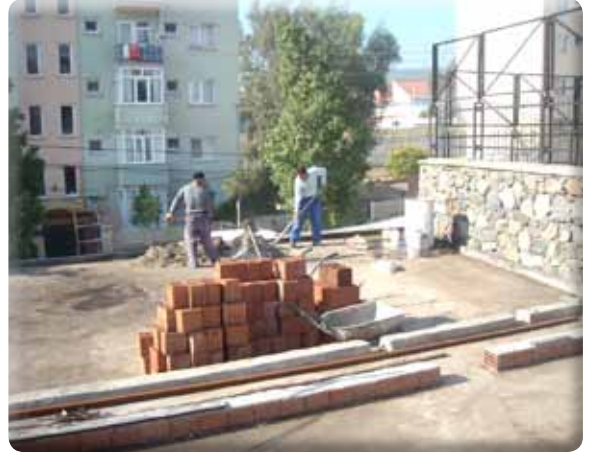
Sevgi Mahallesinde bulunan belediyemize ait olan Halk Eğitim Merkezince kullanılan binanın tadilatı yapılmıştır.
