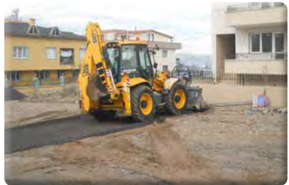
Beyazevler Mahallesi 555 Sokak Asfalt Kırığı Serimi
