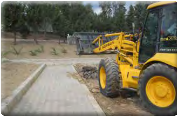
Sevgi Mahallesi Atatürk İ.Ö.O. Yađmur Direnaja Hattı Çalıřması
