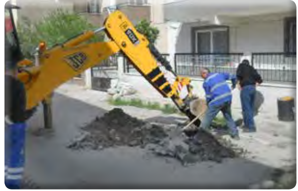
9 Eylül Mahallesi Orhangazi Caddesi No: 63 öñü ızgara yapılması işi.
