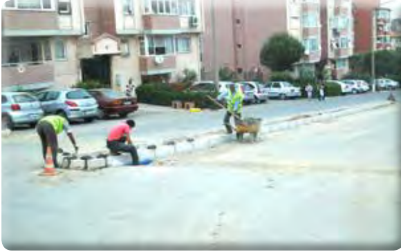
Sevgi Mahallesi Nevvar Salih İğören Caddesi kaldırım yapımı ve yol düzenleme işi.
