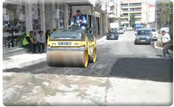
Atıfbey Mahallesi 2, 5 sokaklar ile Etiler ile Feridun Pözüt Caddesi asfalt yama yapılması işi.
