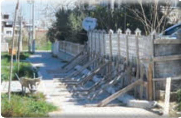
Irmak Mahallesi park yapımında zarar gören duvar tamaratı işi
