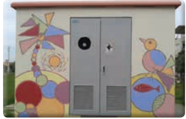
Sarnıç Pazaryeri Trafo Boya Çalışması
