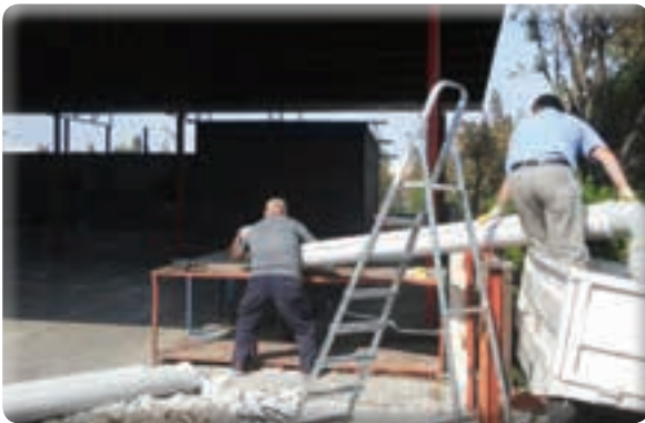
Sevgi Mahallesi Pazar yeri su olukları ve elektrik tesisatı
