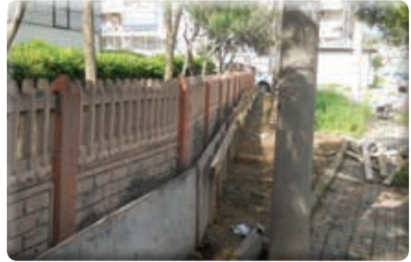
Irmak Mahallesi 93 Sokak kaldırım yapımında zarar gören duvar tamaratı işi
